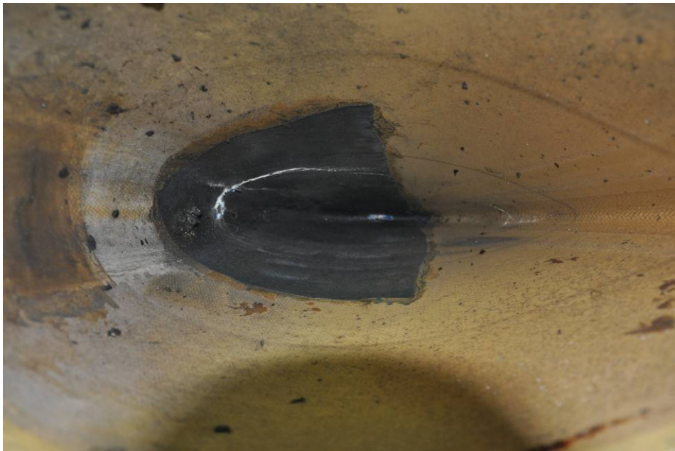
Фотографија 6 – Оштећење носача закрилца са спољашње стране снимљено након демонтаже
