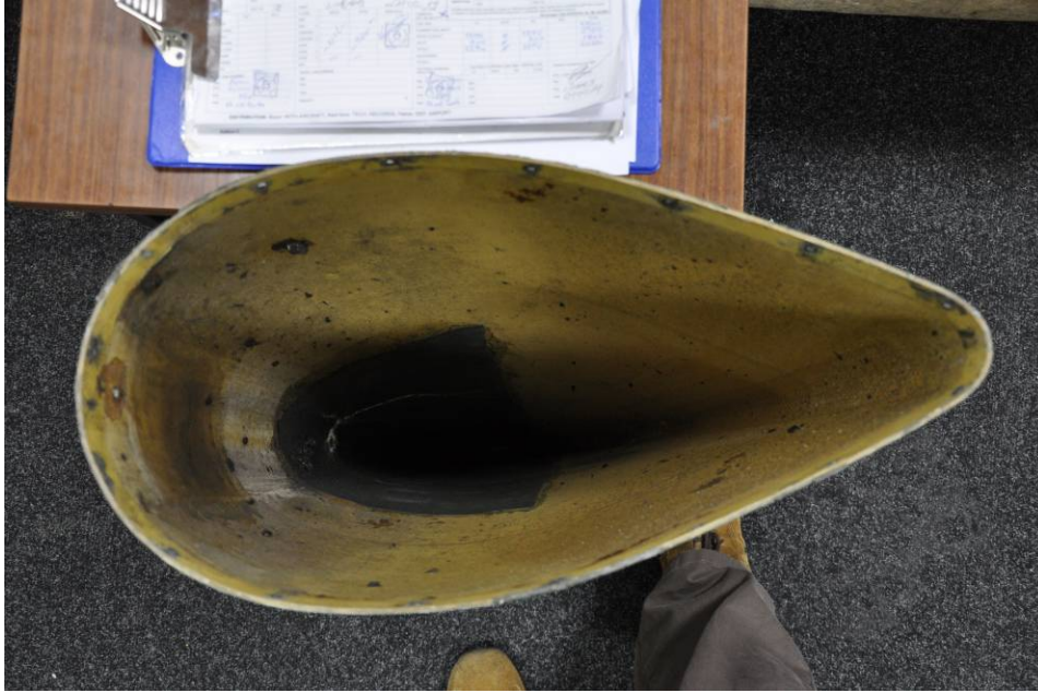
Фотографија 5 – Оштећење носача закрилца са спољашње стране снимљено након демонтаже
