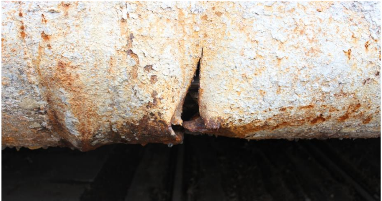
Слика 4.15. Пукотина на узвојном лиму на десном боку
