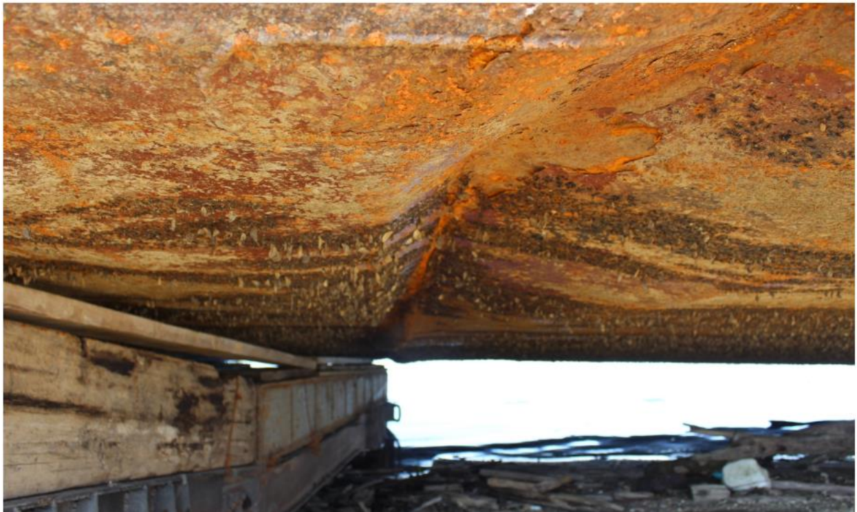
Слика 4.8. Деформација оплате по целој ширини дна (табана)
