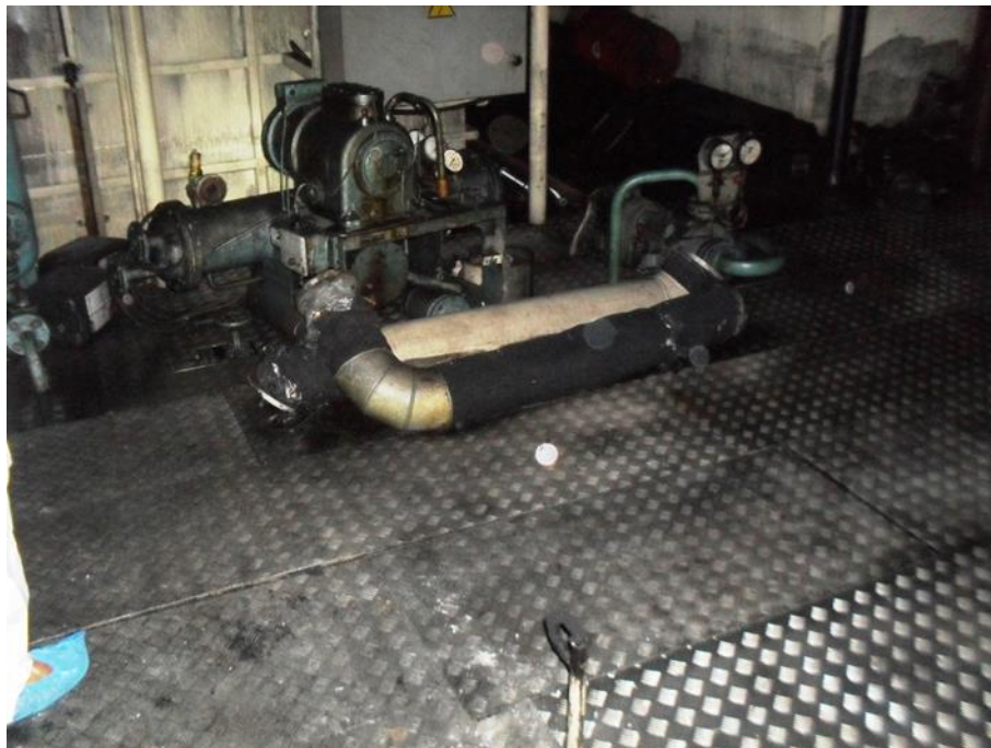
Слика 5.29. Део помоћног машинског простора, приказ пумпне станице
