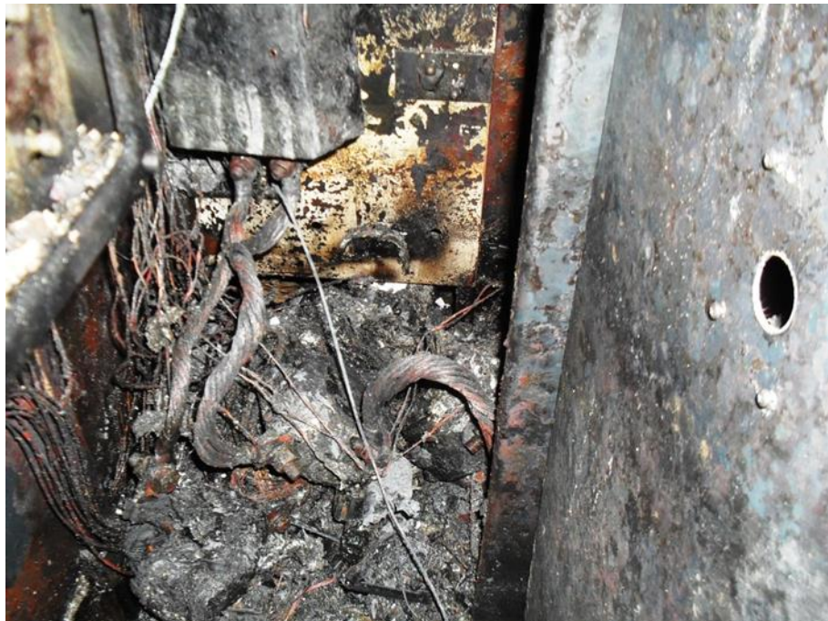
Слика 5.22. Трагови горења највећег интензитета су у доњој зони ГРТ где су сви уређаји пожаром уништени
