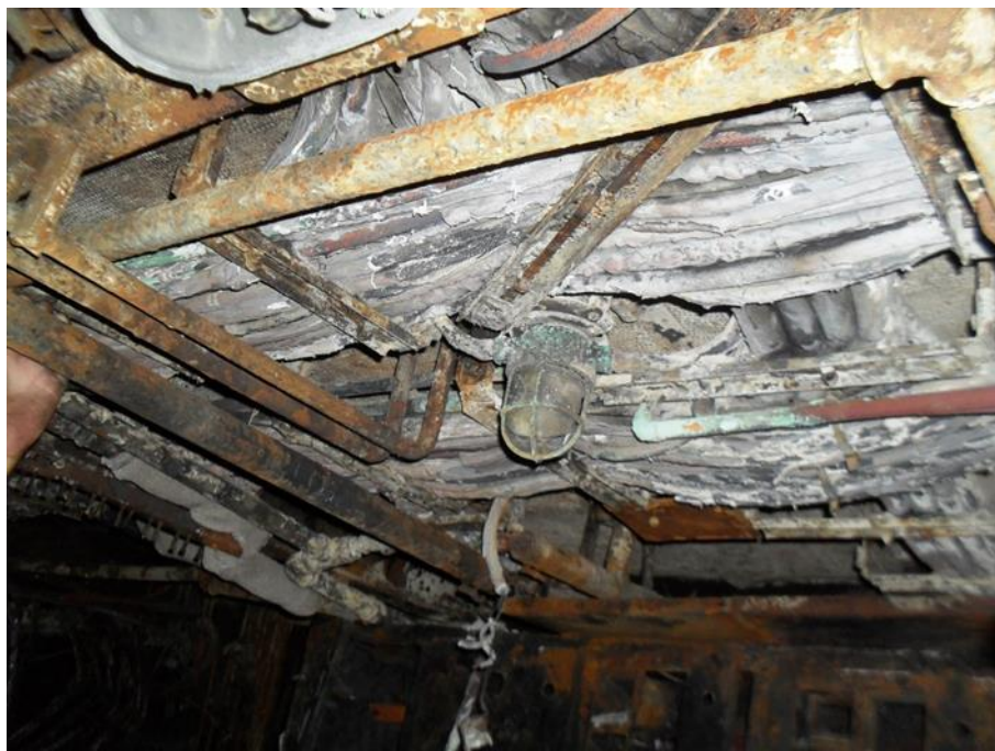
Слика 5.17. Плафон машинског простора
