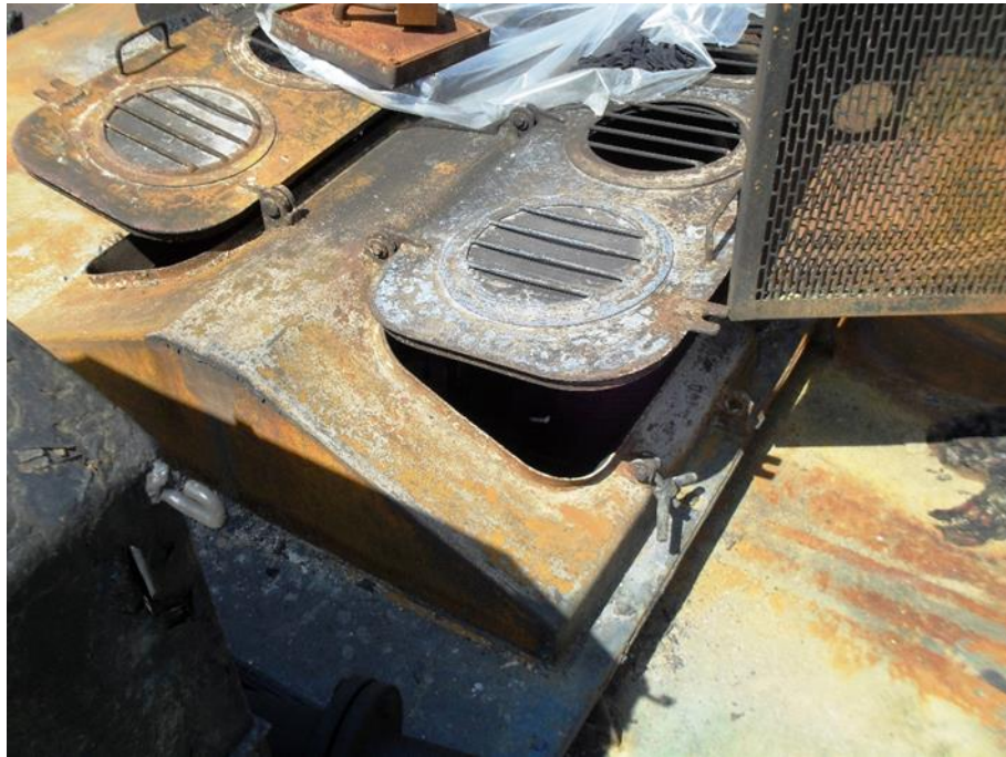
Слика 5.6. Трагови горења на спољашњим површинама изражени на решеткама отвора изнад машинског простора (светларник са отворивим капцима), боја термички деградирана као последица присуства високе температуре
