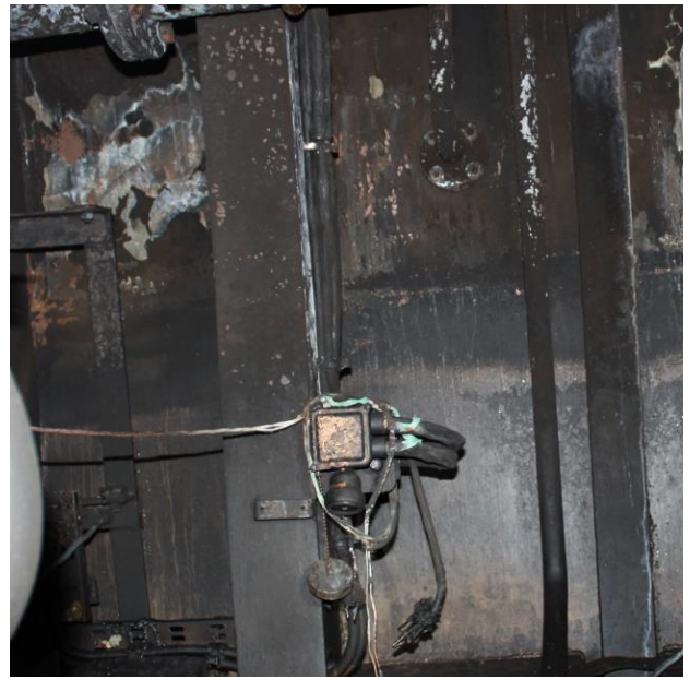
Слика 5.2.3. Оштећени ел. кабл
