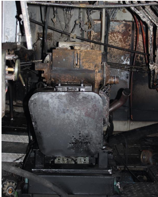
Слика 5.2.1. Оштећен нови агрегат
