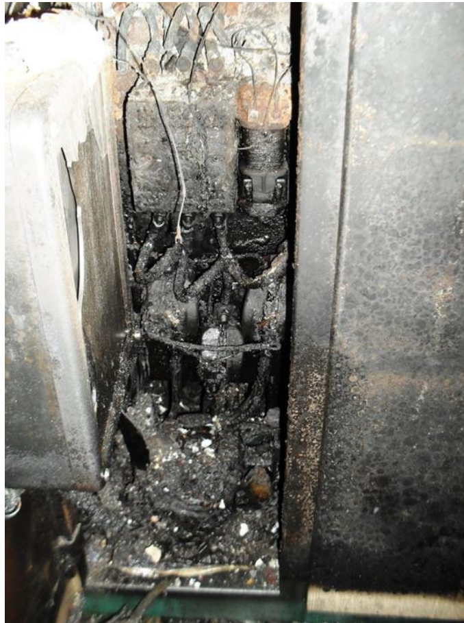
Слика 5.27. Трагови горења у следећем одељку ГРТ, нагорела изолација проводника услед присуства високе температуре
