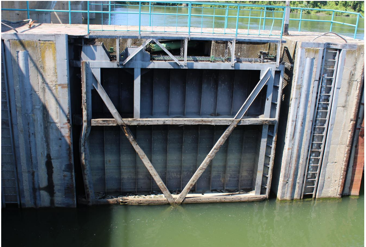
Слика 5.4.1. Оштећење десног крила узводне капије преводнице
