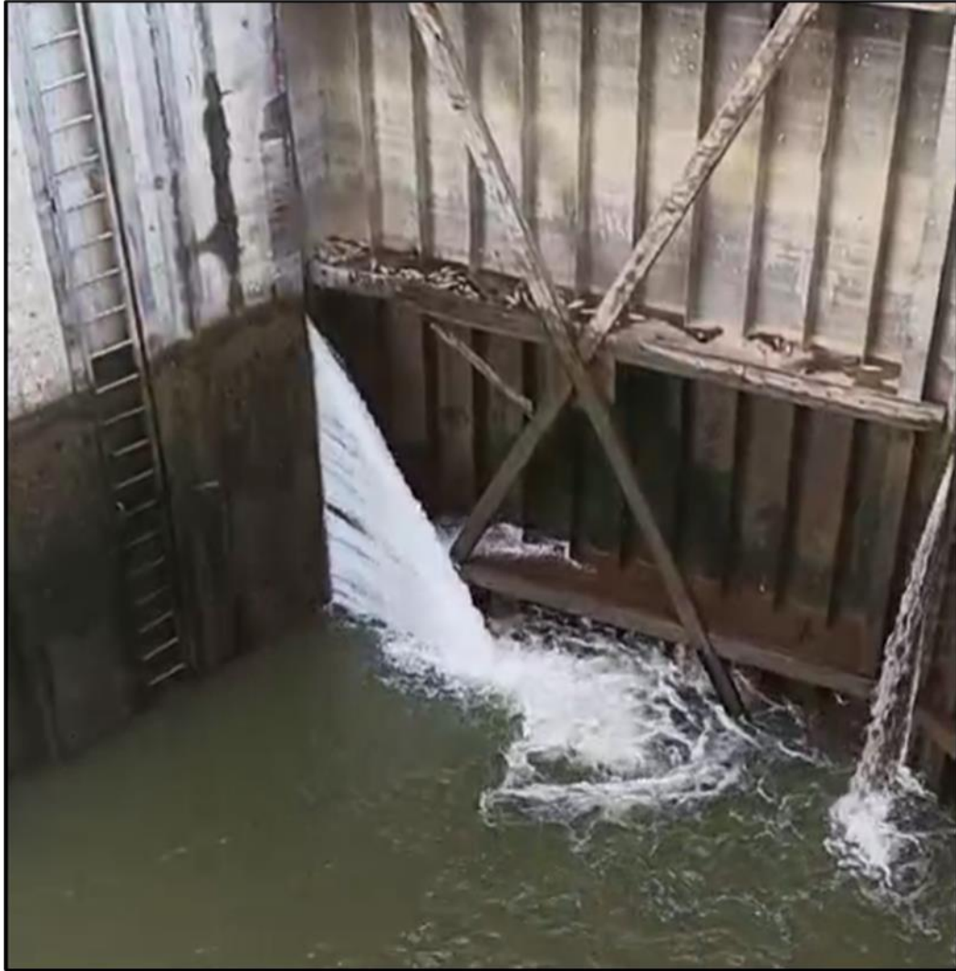
Слика 5.4.2. Последице оштећења горње капије преводнице
