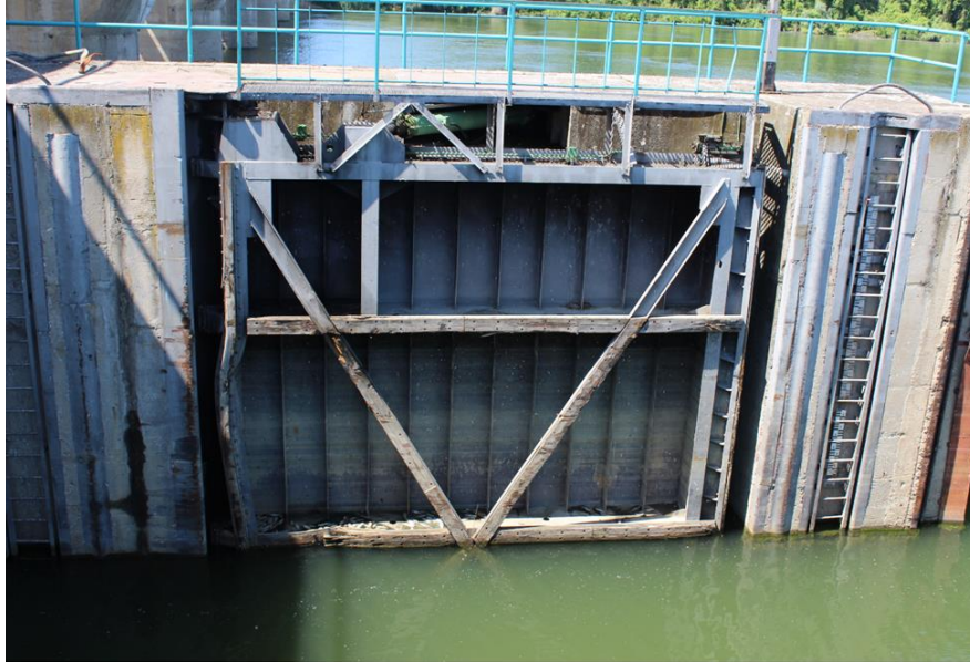
Слика 4.4.1.6. Оштећење десног крила узводне капије преводнице
