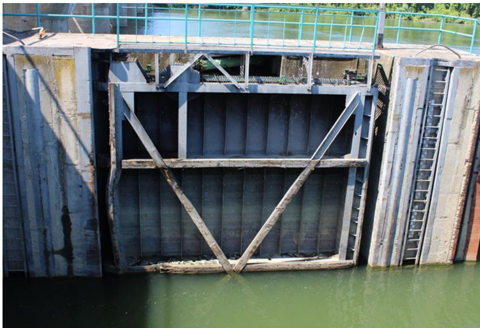
Слика 3.1.2. Оштећење десног крила узводне капије преводнице
