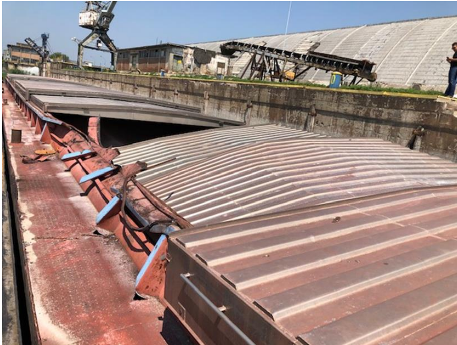
Слика 4.5.1.10. Оштећења на потисници „1024“
