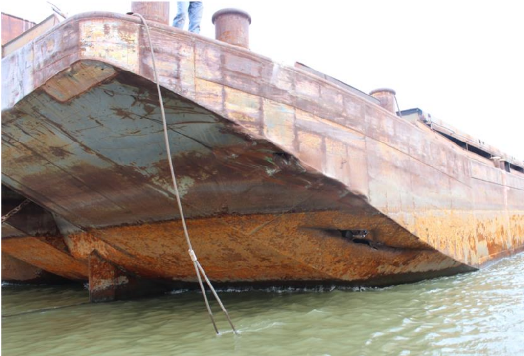
Слика 3.6.5. На потисници регистарске ознаке „UDP-1616“ пробој оплате трупа, дијагонални пробој оплате и улубљење у виду пластичне деформације
