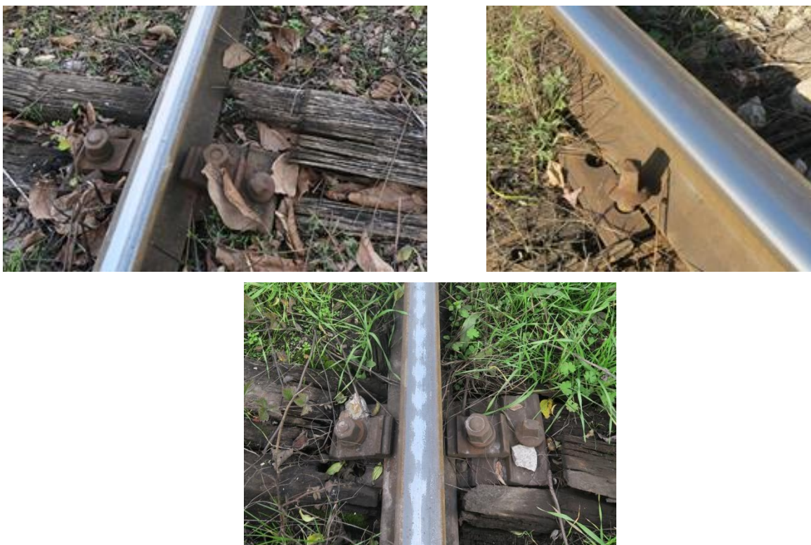
Слика 4.2.5.2: Локална трулеж испод ослонца шине и подужне пукотине прага
